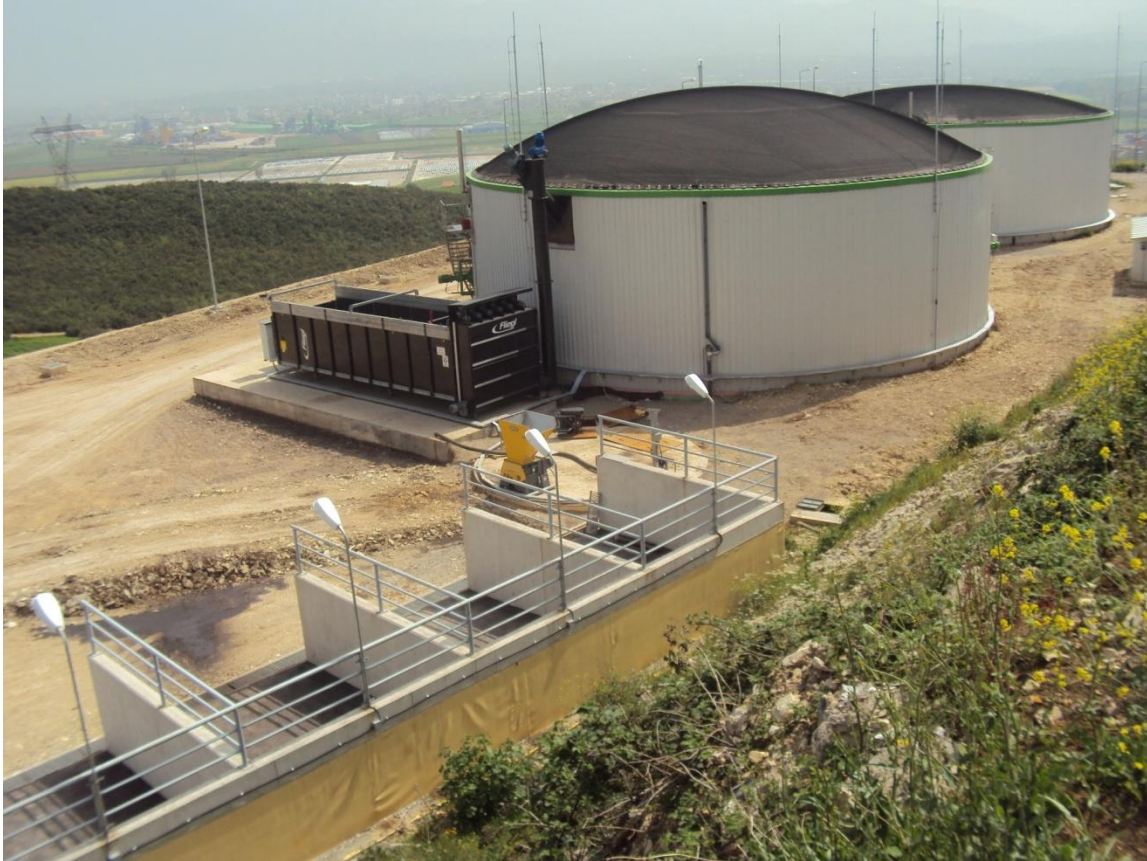
Foto: TUBİTAK MAM Projesi desteği ile yapılan Kocaeli Büyükşehir Belediyesi Biyogaz Tesisi
